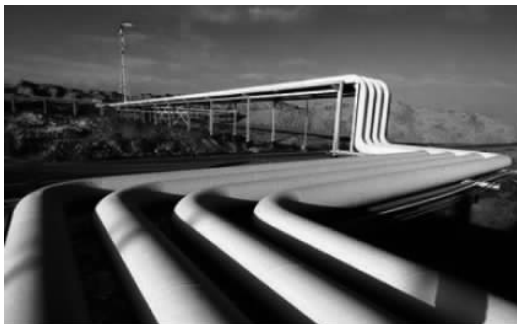
图 3-11 天然气输送管道
