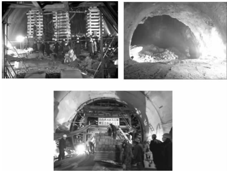
图 1-7 2011 年 4 月 20 日甘肃兰新铁路隧道塌方
