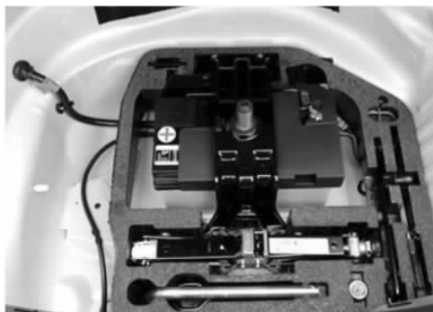
图 3-4 蓄电池安装在后备箱内
