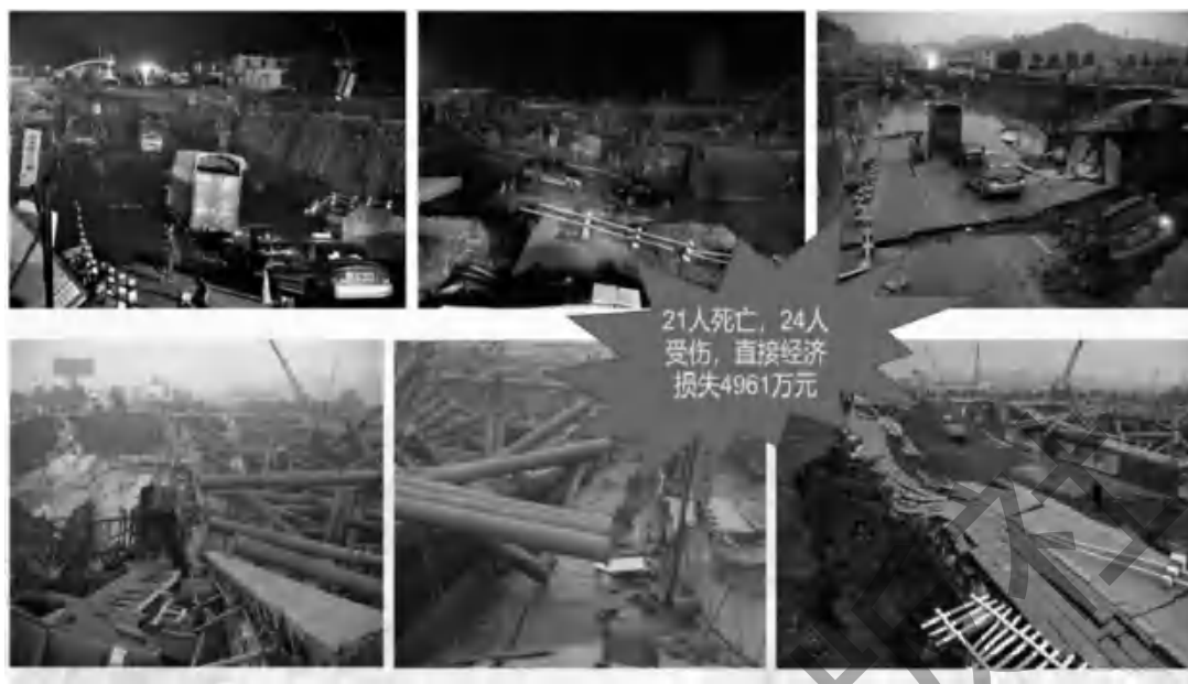
图 1-2 某基坑工程事故照片
