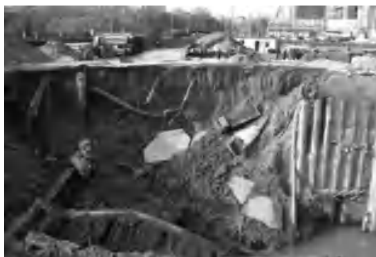
图 1-3 北京地铁十号线某车站基坑塌方事故现场照片
