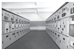
高低压配电系统
