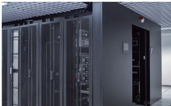
图 1-3 模块化数据中心
