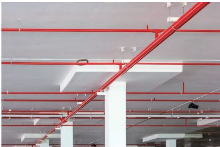
图 1-13 室内消防管道
