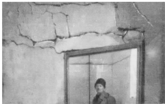
图 0.8 匈牙利一码头建筑物开裂
