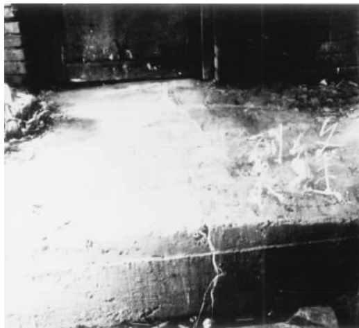
图 0.10 南京分析仪器厂住宅板基断裂
