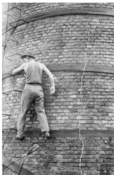
图 0.4 南昌钢铁厂烟囱开裂
