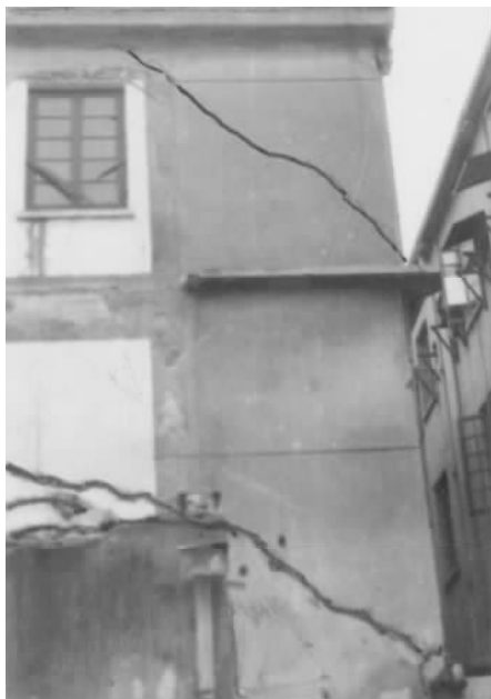
图 0.18 基槽旁辅楼墙体开裂 [14]
